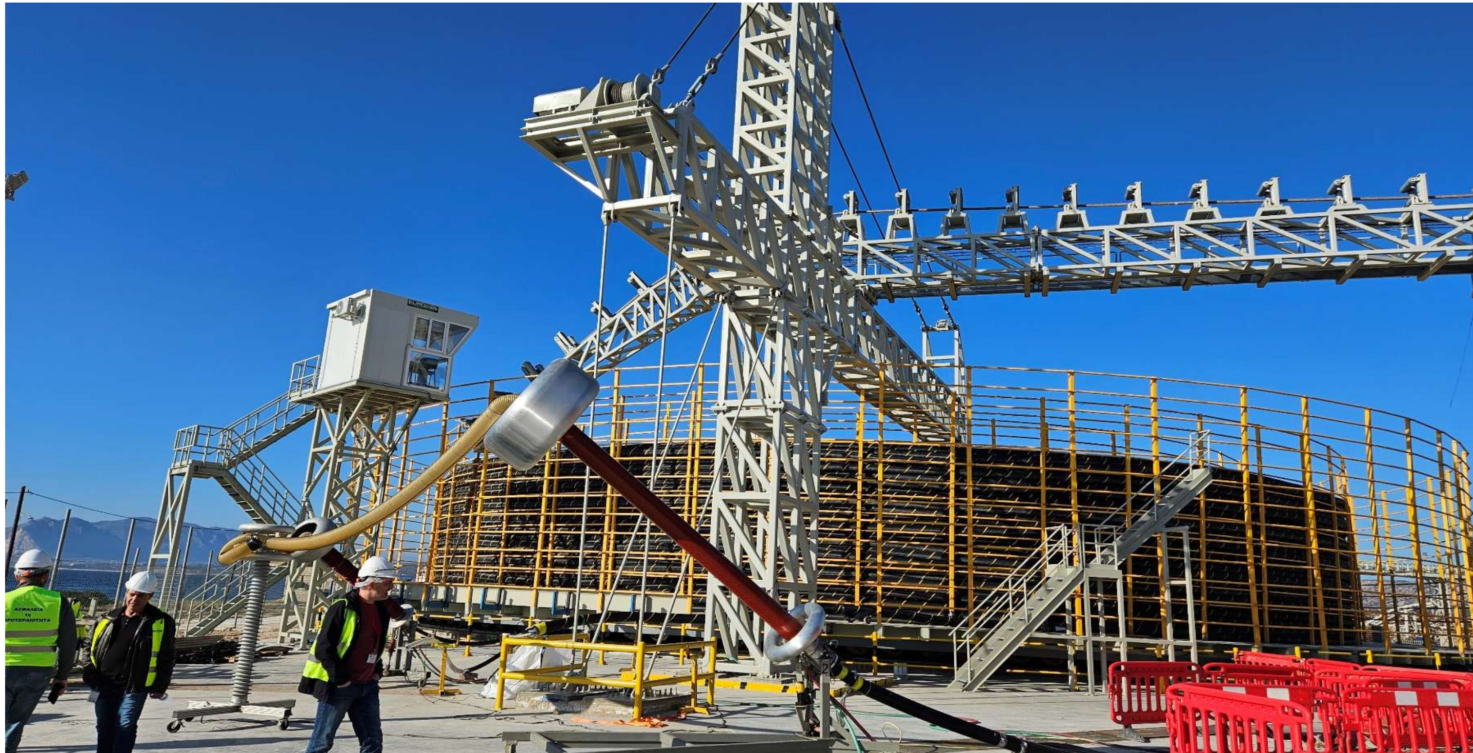
110 kV kabel, priprema za preuzimanje u tvornici FULGOR
